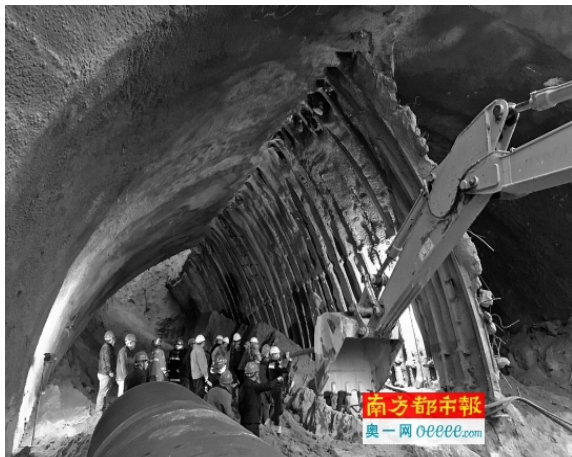
2017.02.25 江门 隧道坍塌 1人死亡
